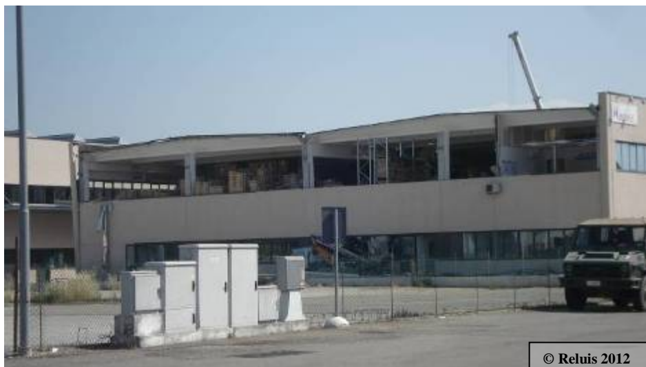
Figura 14 - Collasso pannelli orizzontali di tamponatura
