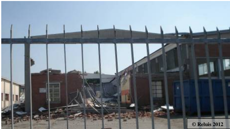
Figura 12 – Collasso edificio prefabbricato
