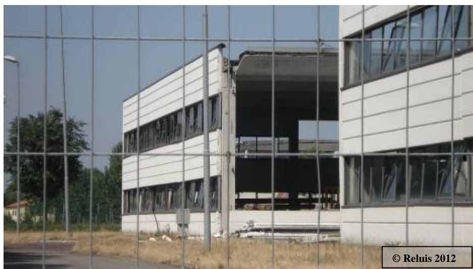
Figura 6 – Collasso pannelli orizzontali di tamponatura
