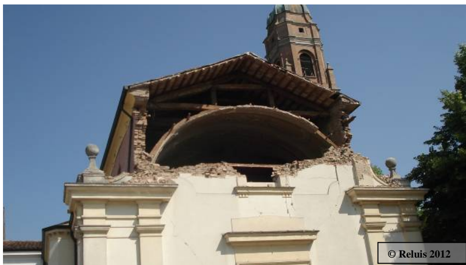
Figura 24 – Ribaltamento del timpano per meccanismo fuori dal piano
