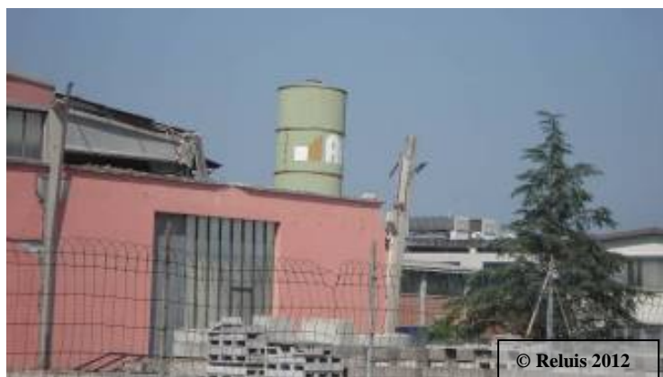
Figura 10 - Collasso copertura e perdita di verticalità dei pilastri
