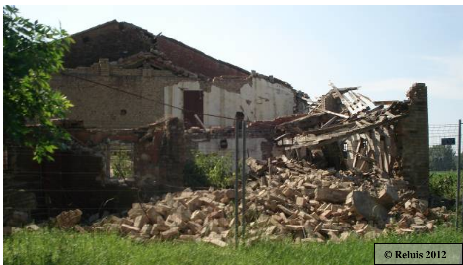
Figura 21– Collasso totale di un edificio in muratura
