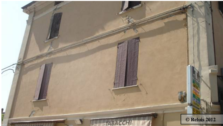
Figura 19 – Fessurazione pannelli di fascia di un edificio in muratura
