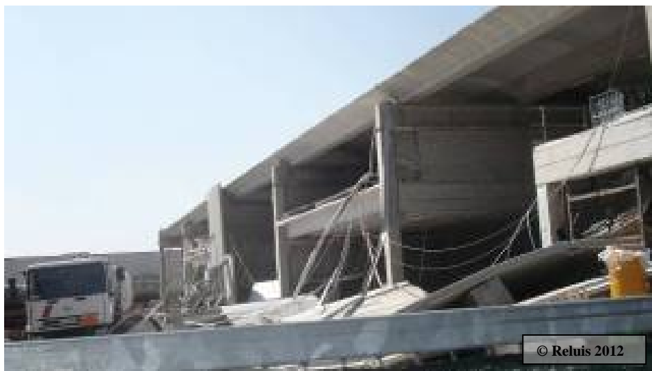
Figura 7 – Struttura con crollo pannelli verticali di tamponatura
