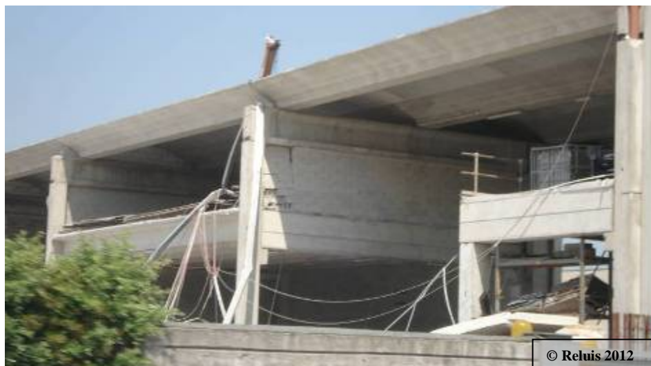
Figura 15 - Collasso pannelli orizzontali di tamponatura
