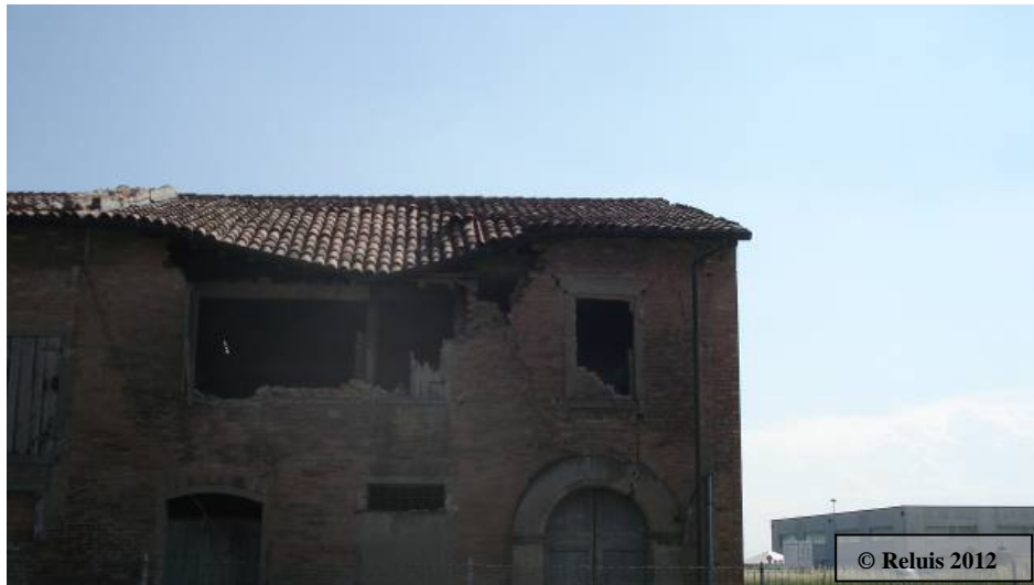
Figura 22 – Ribaltamento fuori dal piano parete con conseguente perdita di appoggio della copertura
