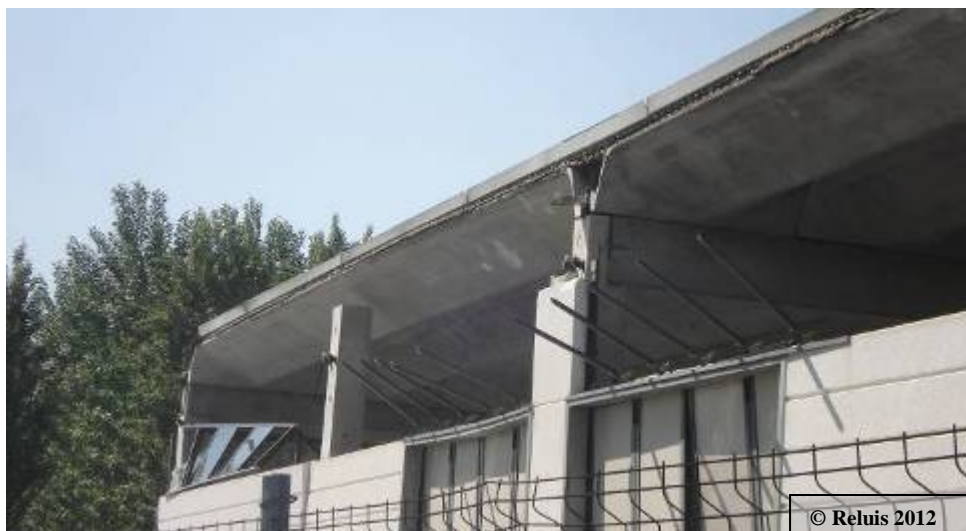
Figura 5 – Collasso pannelli orizzontali di tamponatura
