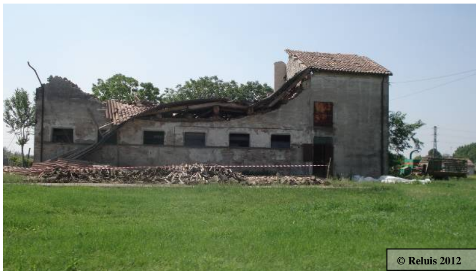
Figura 18 – Collasso copertura spingente e ribaltamento parete muraria con meccanismo fuori dal piano
