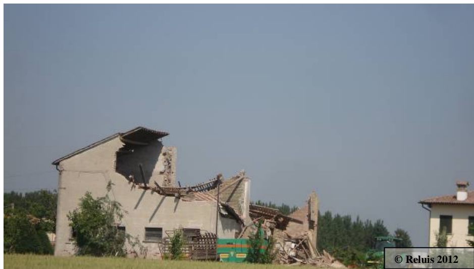
Figura 20 – Collasso totale di un edificio in muratura
