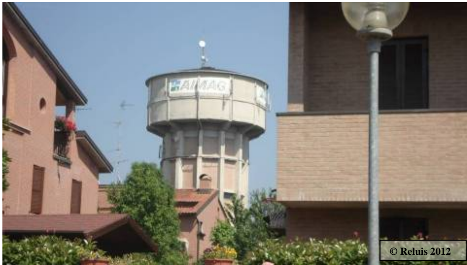
Figura 3 – Serbatoio pensile danneggiato di altezza 40 m. Tale serbatoio è stato svuotato e la zona circostante di raggio 100 m è stata evacuata
