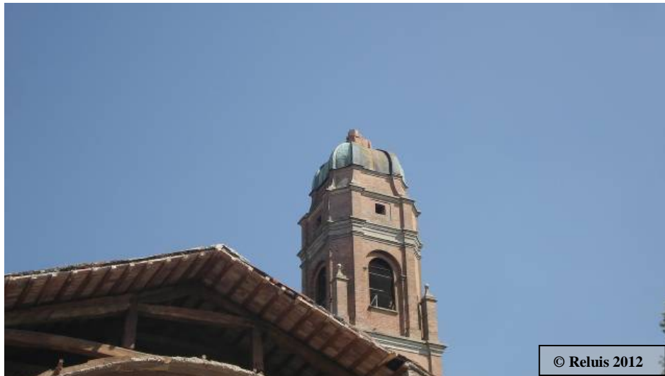
Figura 25 – Danneggiamento del campanile con crollo della parte sommitale
