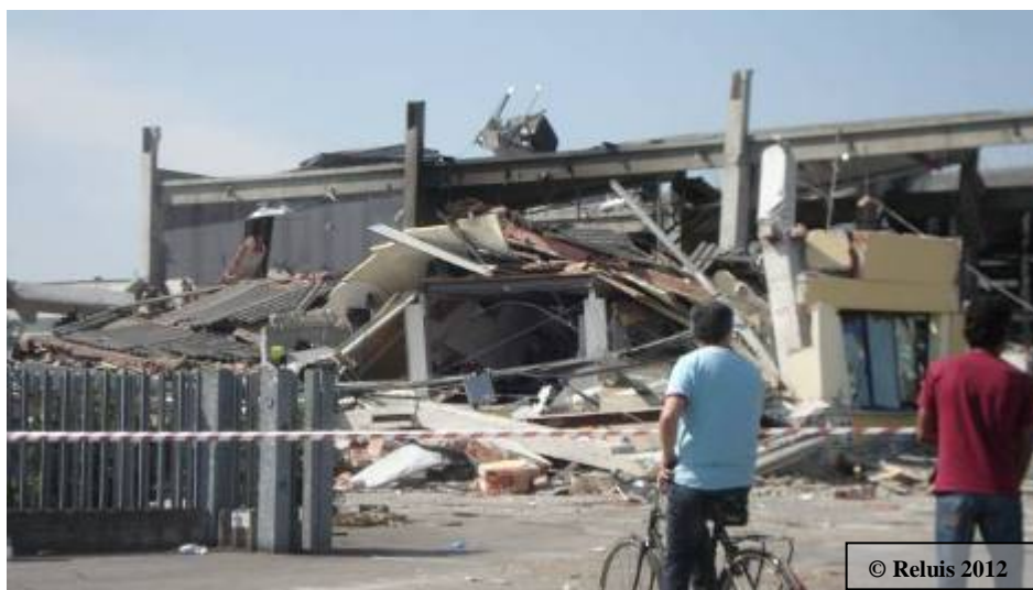
Figura 13 – Collasso parziale di un edificio prefabbricato
