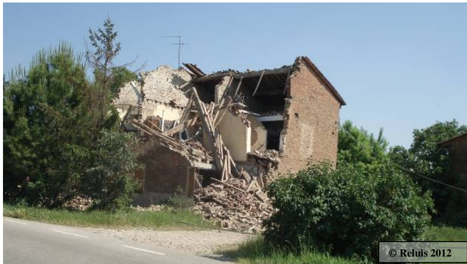
Figura 26– Collasso totale di un edificio in muratura
