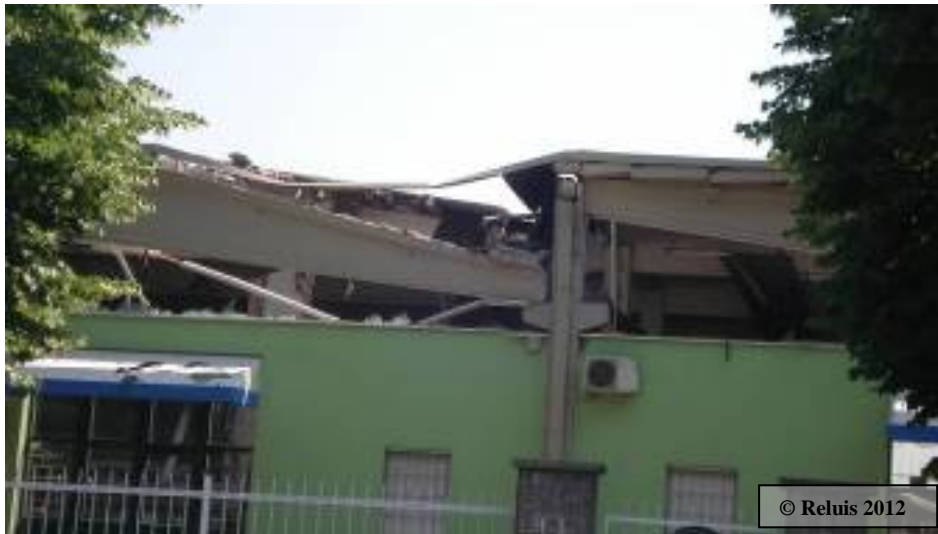
Figura 11 – Collasso copertura, pannello di tamponatura e perdita di appoggio della trave principale
