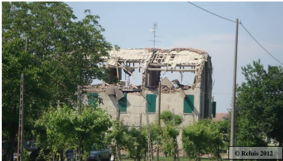
Figura 23 – Ribaltamento della parete muraria con meccanismo fuori dal piano
