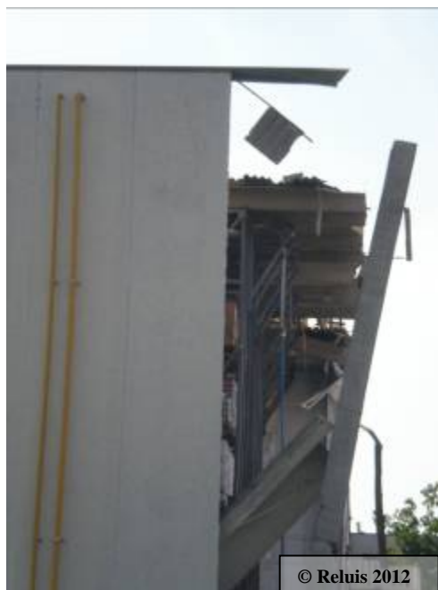
Figura 17 – Collasso pannelli verticali (vista fronte e retro - lato corto dell'edificio) e crisi pilastro
